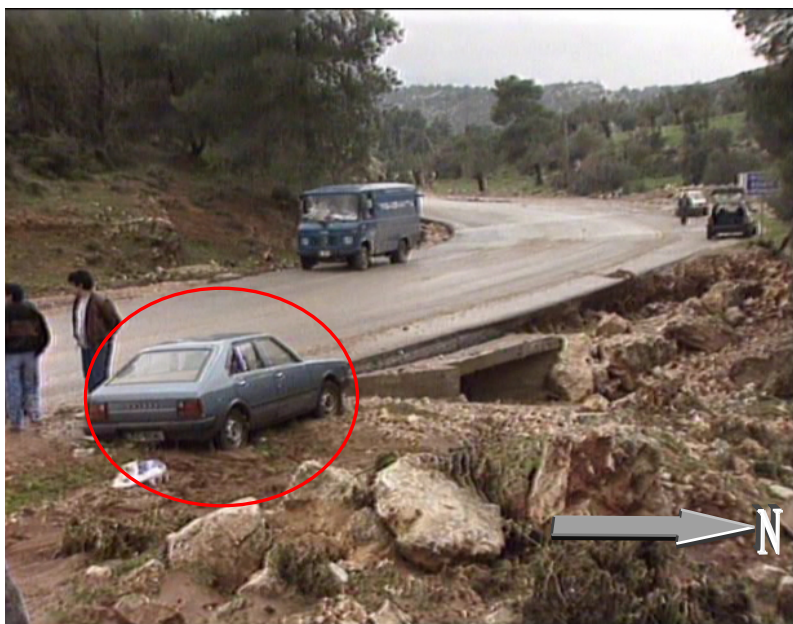
Εικόνα 2-1: 8ο Km Π.Ε.Ο. Ελευσίνας – Θηβών, 27/1/1996. Το σημείο στο οποίο εγκλωβίσθηκε το άτυχος ζεύγος Μαυρομάτη στο αυτοκίνητό τους. Στα δεξιά της εικόνας είναι αποτυπωμένη η διαβρωτική ενέργεια του χειμάρρου, η οποία έχει υποσκάψει τα θεμέλια του οδοστρώματος.
