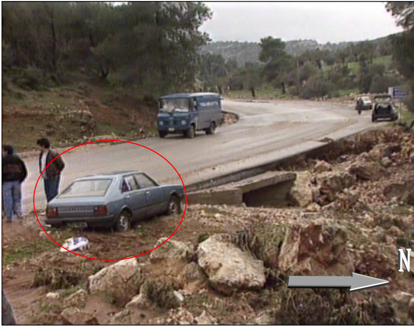
Εικόνα 6-1: 8ο Km Π.Ε.Ο. Ελευσίνας – Θηβών, 27/1/1996. Το σημείο στο οποίο εγκλωβίσθηκε το άτυχος ζεύγος Μαυρομάτη στο αυτοκίνητό τους. Στα δεξιά της εικόνας είναι αποτυπωμένη η διαβρωτική ενέργεια του χειμάρρου, η οποία έχει υποσκάψει τα θεμέλια του οδοστρώματος. Άξονας Εθνικής Οδού και άξονας κοίτης ταυτίζονται .
