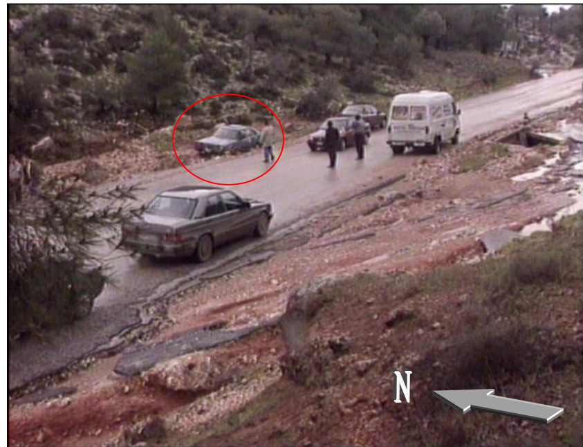
Εικόνα 6-2: Διαφορετική οπτική γωνία της εικόνας 6-1. Διακρίνονται α) τα πρανή εκατέρωθεν της κοίτης με αυξημένη κλίση που διαδέχθηκαν ένα ηπιότερο ανάγλυφο β) η διαβρωτική ενέργεια του χειμάρρου, και το κατεστραμένο τμήμα οδοστρώματος γ) ο άξονας της Εθνικής Οδού και ο άξονας της κοίτης ταυτίζονται δ) ο αγωγός εκτροπής της κοίτης, φυσικά μη διαστασιολογημένος για πλημμυρικές απορροές με μεγάλη περίοδο επαναφοράς.
