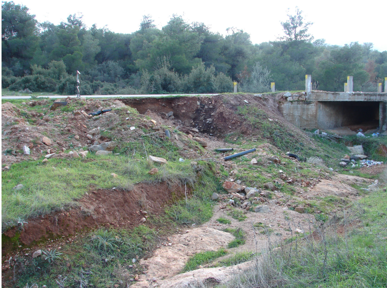
Εικόνα 8-3: Το σημείο AGK4 στο χειμάρρο της Αγίας Αικατερίνης, όπου παρατηρείται αύξηση στην ενέργεια (stream power). Είναι εμφανής η διάβρωση της αναβαθμίδας και του επιχώματος του δρόμου, με αποτέλεσμα μικρής κλίμακας ολίσθηση γαιώδους μάζας. 100 μέτρα κατάντη του σημείου αυτού (βλ. Εικ. 8-6) προτείνεται αντιπλημμυρικό έργο με γεώτρηση εμπλουτισμού και ανασχετικά φράγματα, τα συρματοκιβώτια των οποίων μπορούν να αποτελέσουν και μέτρα αντιστήριξης των εκατέρωθεν πρανών.
