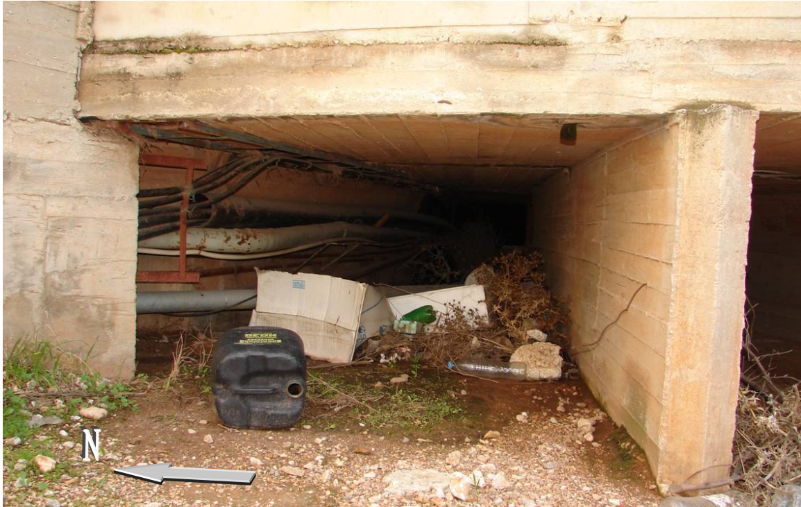
Εικόνα 2-12: Η κοίτη του χ. Σούρες κάτω από τη ΒΑΚΟΝΤΙΟΣ ΑΕΒΕ – Αριστερό τμήμα της διατομής διαστάσεων 2,20 m πλάτος x 1,20m ύψος. Σκουπίδια και πάσης φύσης φερτά υλικά, ανά πάσα στιγμή μπορούν να φράξουν το στόμιο. Υδραυλικά και ηλεκτρικά στοιχεία σε άμεση επαφή με το νερό.
